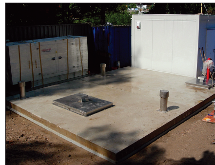
Tłocznia ścieków przy ul. Prusa w Szklarskiej Porębie.
