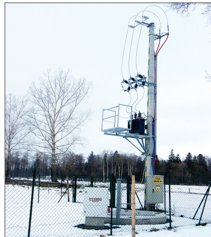
Przepompownia główna w Miłkowie
